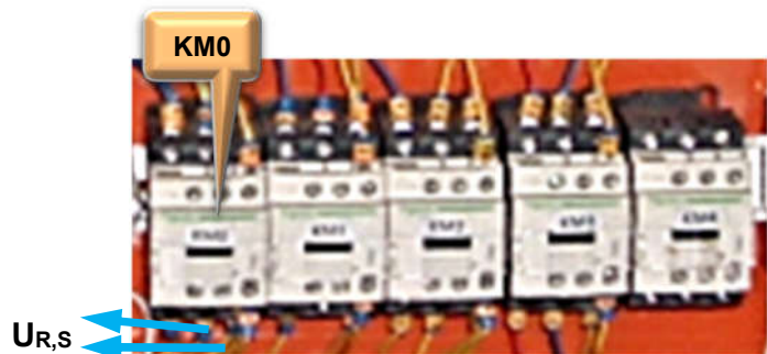
Hình 9.6: Đo điện áp ngõ ra công tắc tơ KM0
