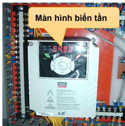
Hình 9.7: Kiểm tra màn hình biến tần
